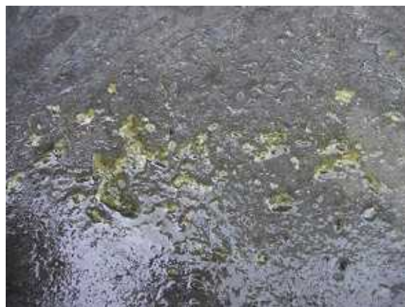
07 銅管内異物(ヘドロ状)
